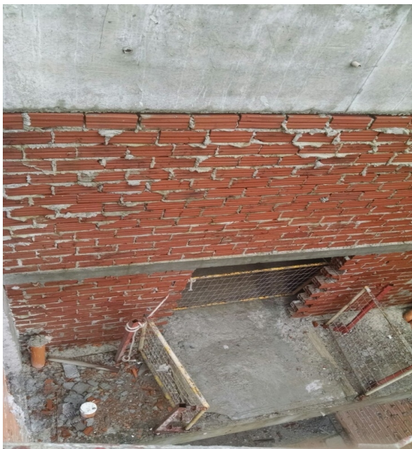
Figura 1. Encunhamento não executado corretamente com argamassa
