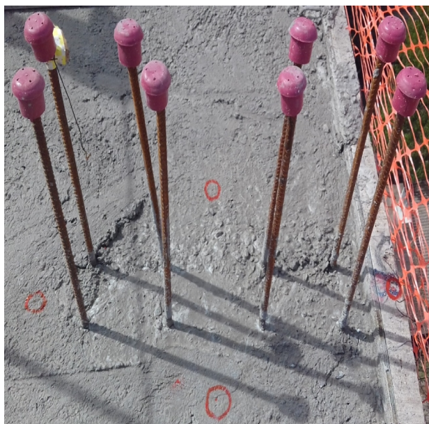
Figura 2. Eixo de pilares marcados e armaduras com ponteiros de proteção. Fonte: Próprio Autor (2016).
